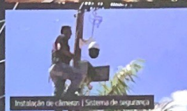
Instalação de câmeras / Sistema de segurança
